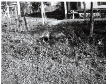
Imagem do lançamento de esgoto a céu aberto na rua, constante no Plano Municipal de Saneamento Básico Participativo de Capela de Santana/RS/2012.
